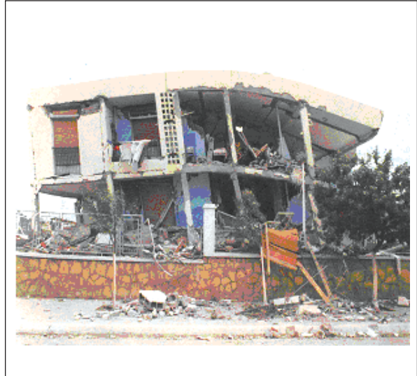
4. Dégâts provoqués par un séisme
