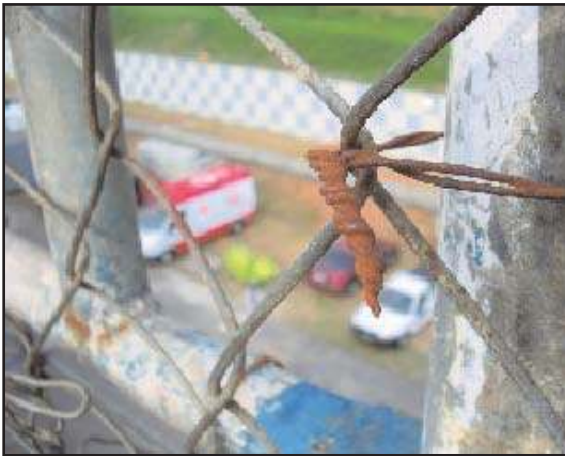
Corrosion du fer
