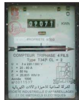
Fig.9- Compteur d'énergie électrique
