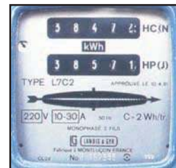
Fig.10- Compteur d'énergie double tarification
